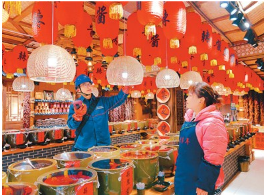
春节将至,贵州省贵阳市花溪区青岩古镇沿街商户纷纷挂上灯笼,游客络绎不绝,年味十足。南方电网贵阳供电局工作人员每天走街入户对商户电路电器进行安全检测,全方位保障春节期间用电安全与稳定。 万 伟摄(人民视觉)
